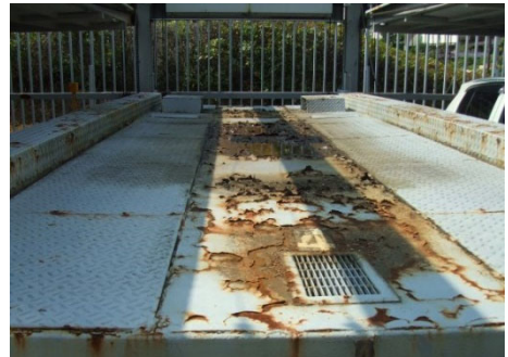
図 22 立体駐車場の腐食
