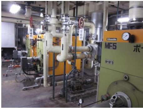
図 19 更新時期を迎える熱源設備
